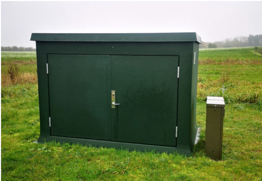
Figur 2 Overjordisk råvandsstation ved Køge Vands Fruedal boring 3, DGU nr. 212.1038.
